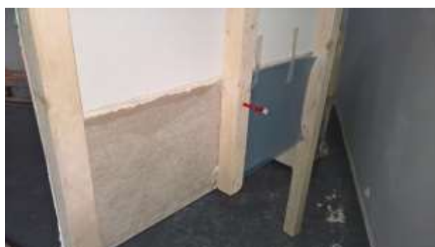
Kasteltu alaosa ja mittausputki referenssimittarille
