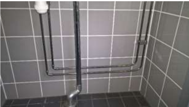
Metalliset vesi- ja viemäriputket voivat estää anturien lukemisen
